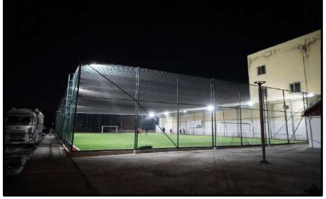
Gümüşçeşme Mahallesi Halı Saha Aydınlatması
